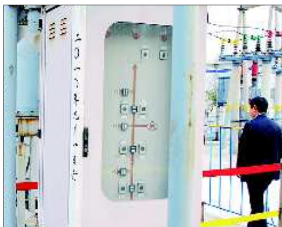
为执行济宁限电限产政策,在兖矿峰化公司的变电站内,控制电源开关的配电箱被贴上了封条。
