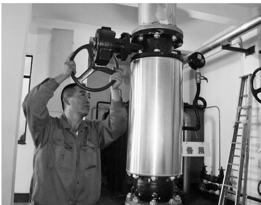
台东供热站的工作人员正在对设备进行检修,随时准备供热。 本报记者 孟艳 于健 陈海芹 摄
