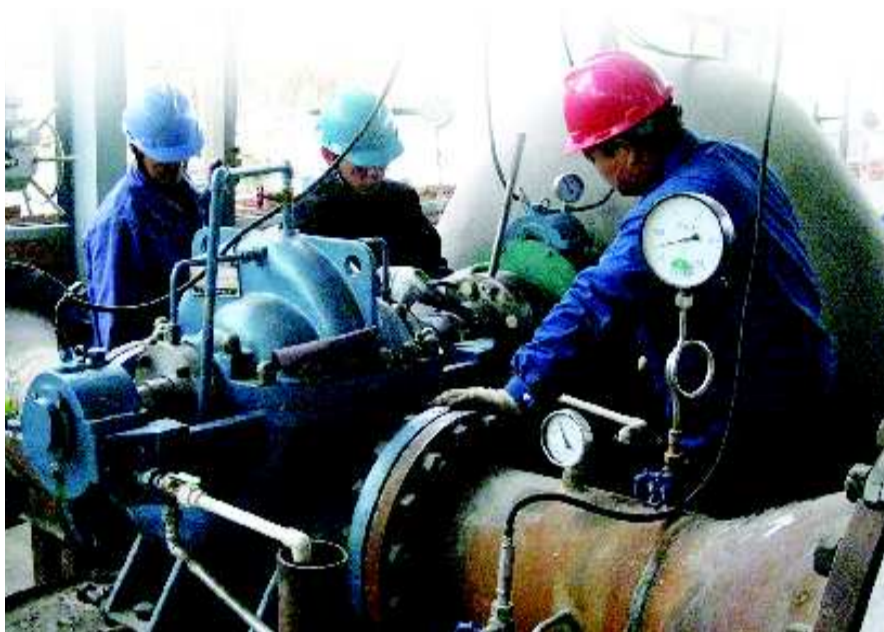
热试运首日,工作人员在高温水首站调试设备。 本报记者 刘守善 摄
