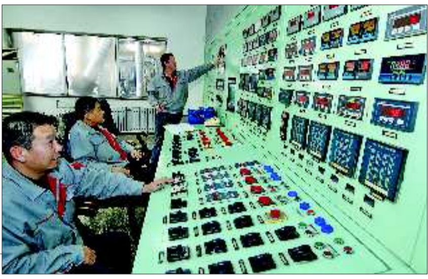
11月4日,济南北郊热电厂内,工作人员正在已经运行的锅炉操作盘前进行监控。 本报记者 王媛 摄
