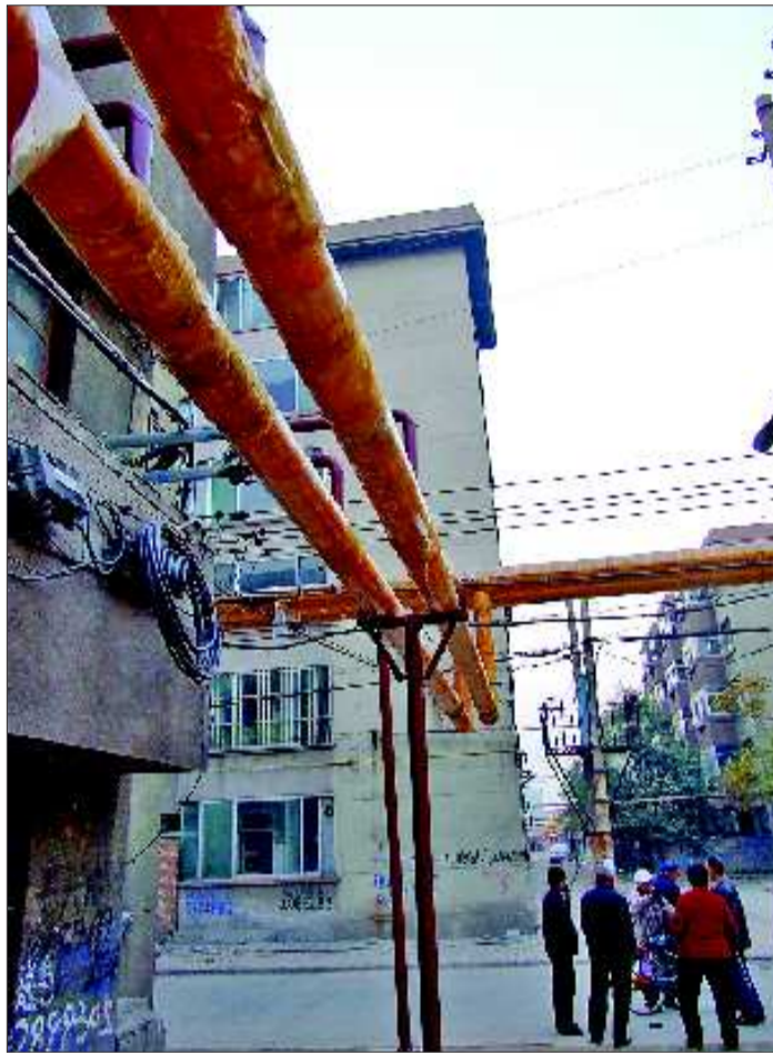
11月9日,供暖日期临近,德州天衢小区今年刚安装上的供暖管道才包上保温层,而有一些居民还是因供暖面积争议问题没有交上采暖费。 本报记者 苏超 摄
