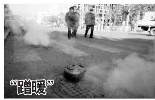
15日,在潍坊市虞河路人民医院南侧,有市民将一个水壶放在了热力井的井盖上。据路边店铺的人介绍,这个热力井从供暖的第一天就开始冒热气,井盖的温度大约在70℃,非常烫,放一壶水在上面半个小时就很热了。 本报记者 孙国祥 摄影报道
