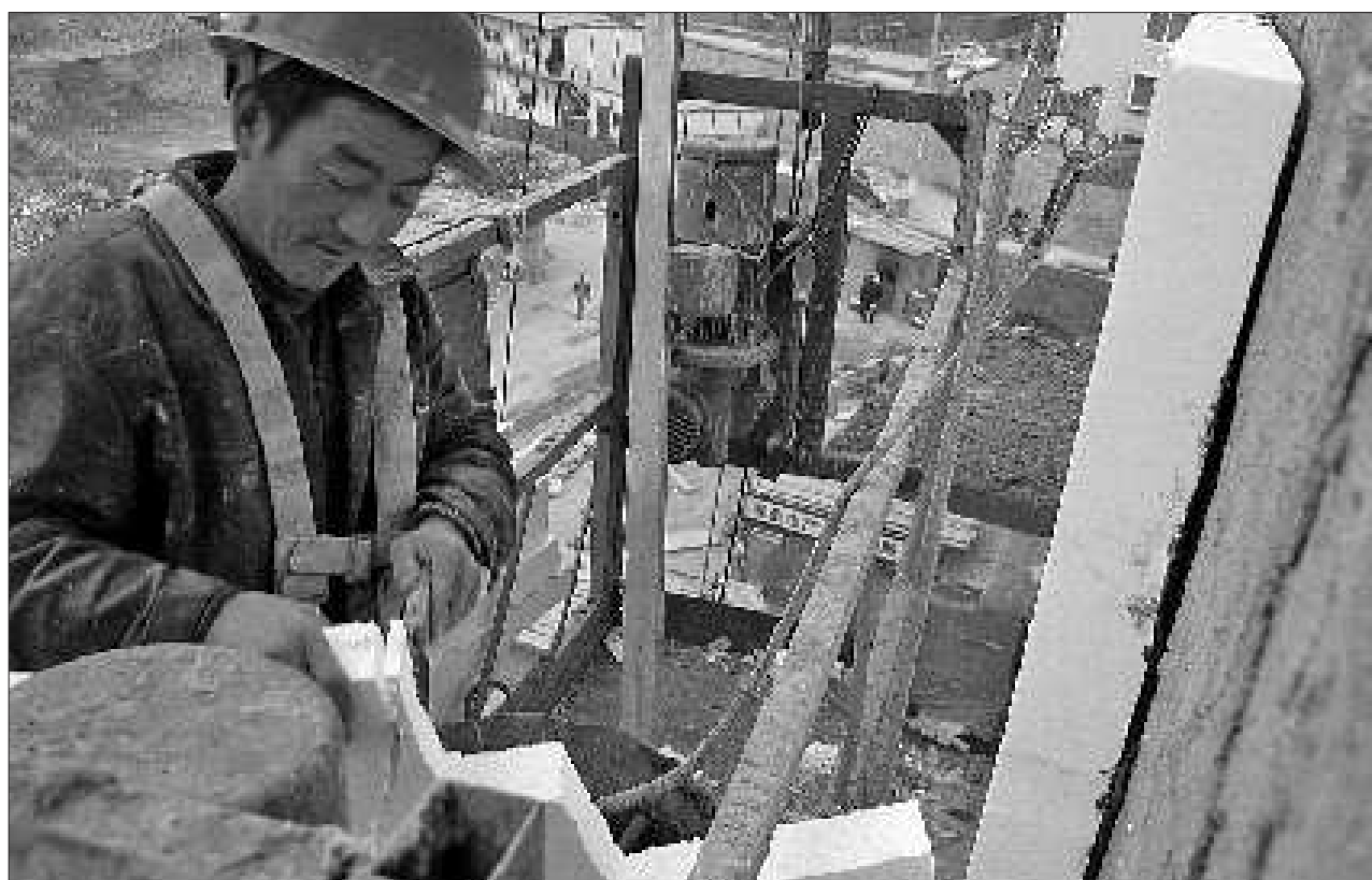
17日下午,省城泺源大街一处建筑工地,工人正在为高楼外墙安装保温层。本报记者 左庆 摄
