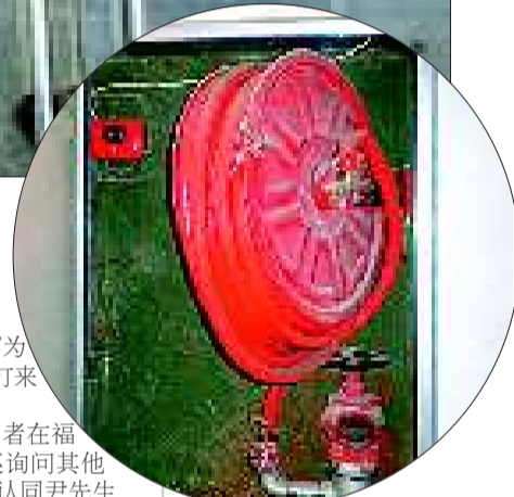
记者在26楼拉开消防栓,里面的消防设施缺少好几样。
