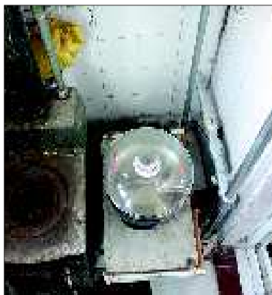
纪先生家阳台厨房里新装的燃气管道与煤炉距离很近。赵恩霆 摄
