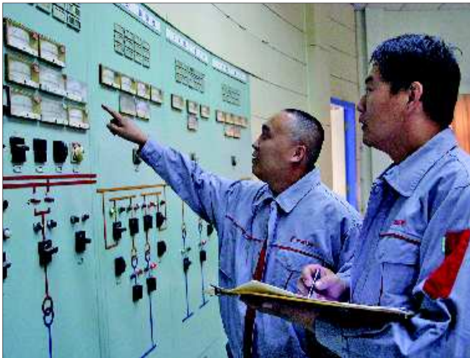
热电工作人员查抄供暖运行参数。 通讯员 范文 摄
