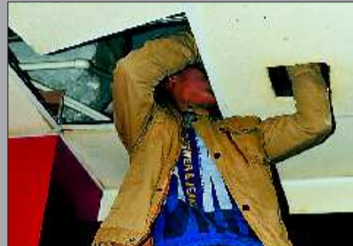
“王伟”打开顶棚查看情况
