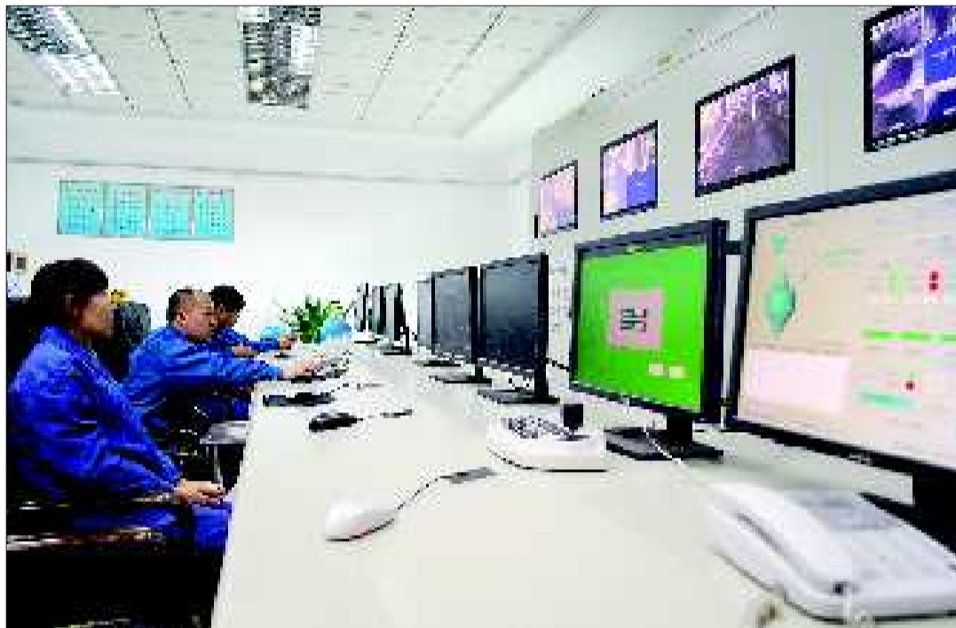
随着气温的下降,东郊热电厂将适当提温,图为工人在控制室内监测设备运行情况。
