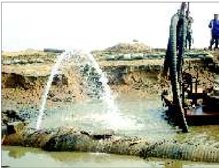
河内的输水管道出现毁损(实康水务公司提供)
