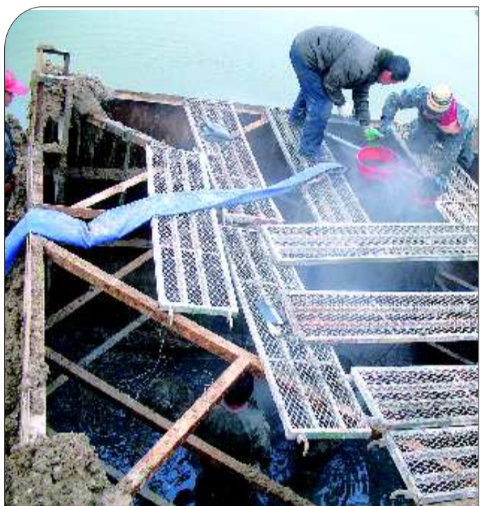
22日下午,施工人员用水桶将沉箱内的泥水向外清理。 本报见习记者 郝文杰 摄
