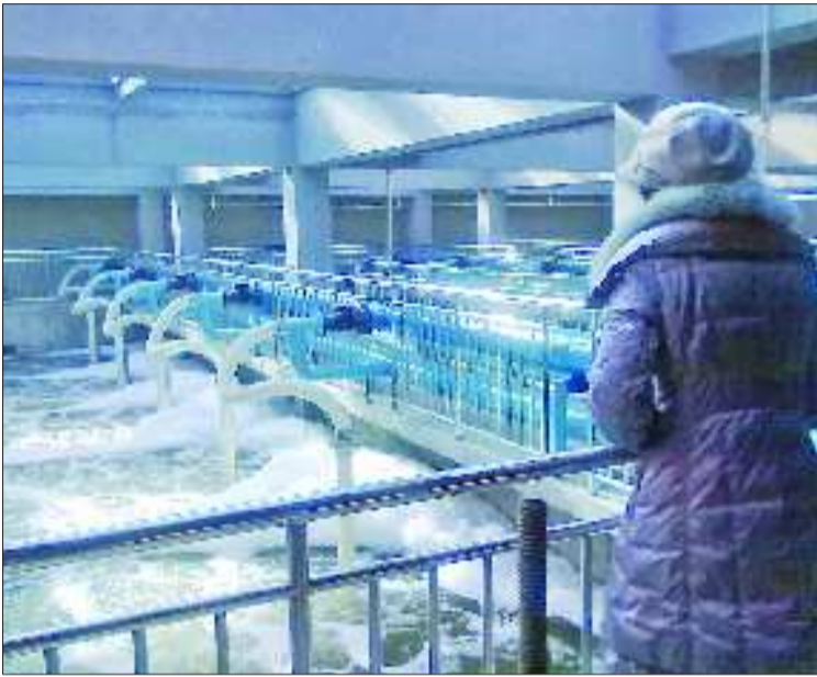
奥体中心中水站的反应池里使用了先进的污水处理技术。师文静 摄
