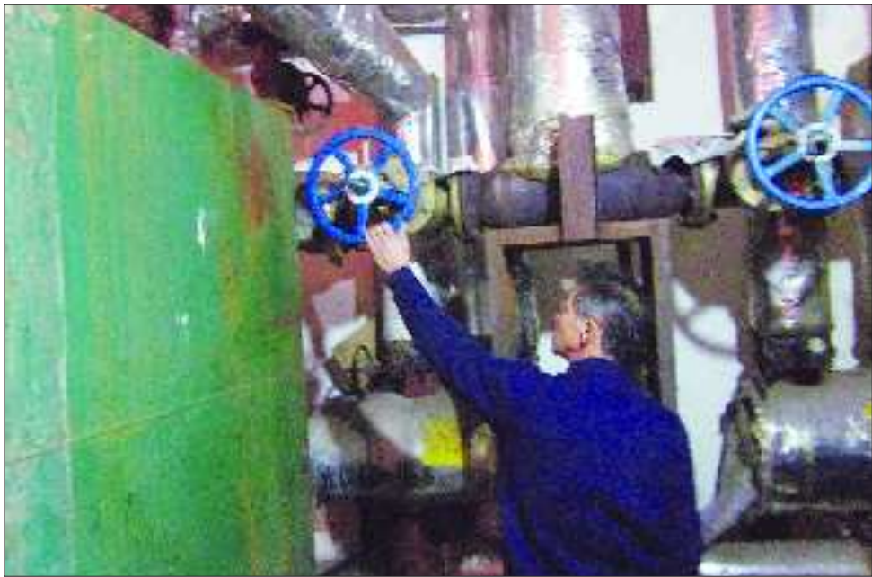
1月10日晚,汇科旺园小区自管站开大阀门,保证供热。
