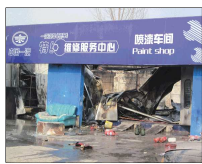
被火烧过的喷漆车间一片狼藉, 车间屋顶坍塌。 本报记者 王尚磊 摄
