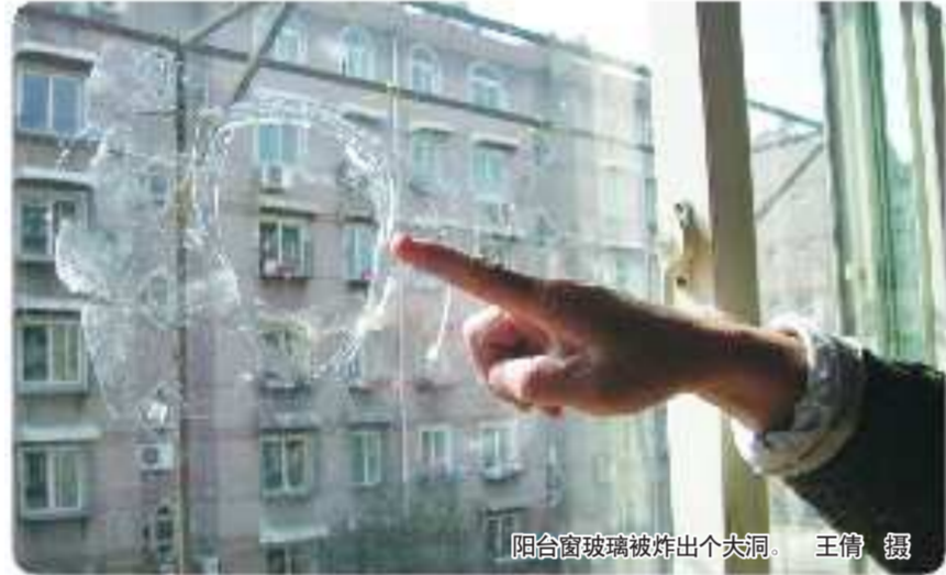
阳台窗玻璃被炸出个大洞。 王倩 摄
