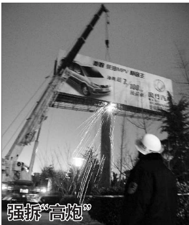
27日晚7点到12点,位于重庆南路与长沙路路口附近一院内绿化带内的无审批手续高炮广告被强制拆除。据悉,重庆南路(四方段)共有非法设置高炮广告21座,将在1个月内拆除完毕。 本报记者 苑菲菲 本报通讯员 周欣 摄影报道
