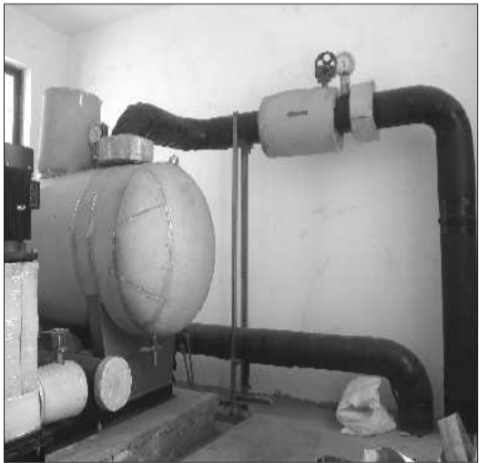
春都花园改造后新安装的二次加压设备。宗韶峰 摄
