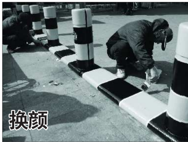
13日，在台东三路步行街，工人们正在用防锈漆粉刷挡车护栏。据现场工人介绍，台东三路步行街一共有6处挡车护栏，由于风吹日晒，多出现生锈、脱皮问题，需要及时维修保养。 本报记者 张晓鹏 摄影报道
