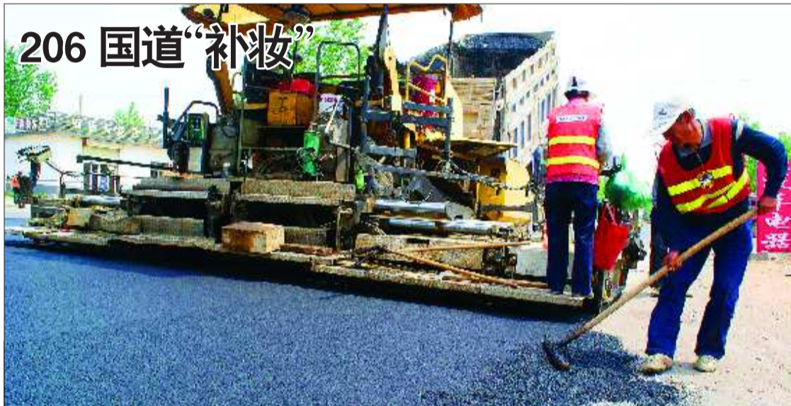
5月3日上午11时许,在206国道税郭镇驻地附近路段,施工人员正在利用大型机械给道路铺设沥青。公路部门提醒市民,206国道“补妆”路段全长13公里,从5月1日开始,预计于5月10日完工。由于该路段交通流量比较大,过往车辆及行人途经该路段时,要注意安全,减速慢行。
