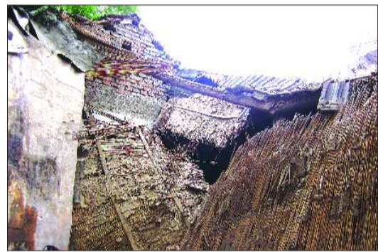
倒塌房屋一片狼藉。 刘德峰 摄
