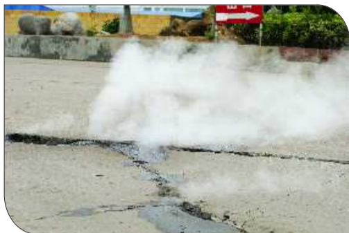
加气站出口处的地缝中冒出热气和少量的水 见习记者 宋腾龙 摄
