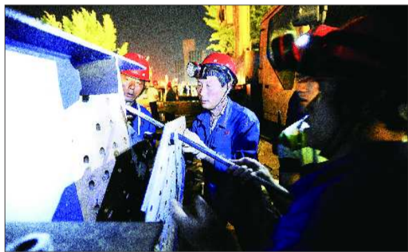
每段主梁在吊装前都要安装7800多个高强螺栓,且都需人工采用专用扳手拧紧。
