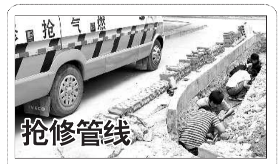
抢修管线 5月24日,辽河小区东区施工人员进行暖气改造施工时不慎将2号楼北侧的天然气管线挖坏,导致管道漏气。据悉,黄河燃气公司的工作人员经过半个小时的抢修,燃气恢复。 本报见习记者 王健 摄影报道
