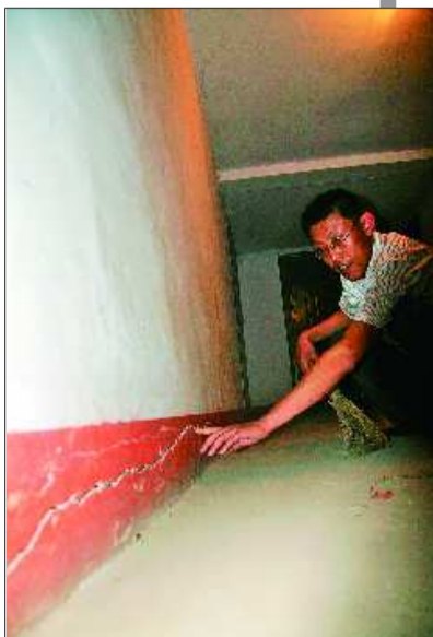
4号楼地下室门口的裂纹十分明显。
