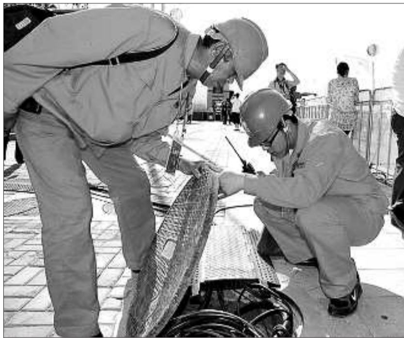
市区供电部员工在检查供电设施,保证“铁三赛”用电。
