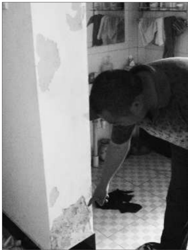
很多墙皮都脱落了,有的地方已经发霉。
