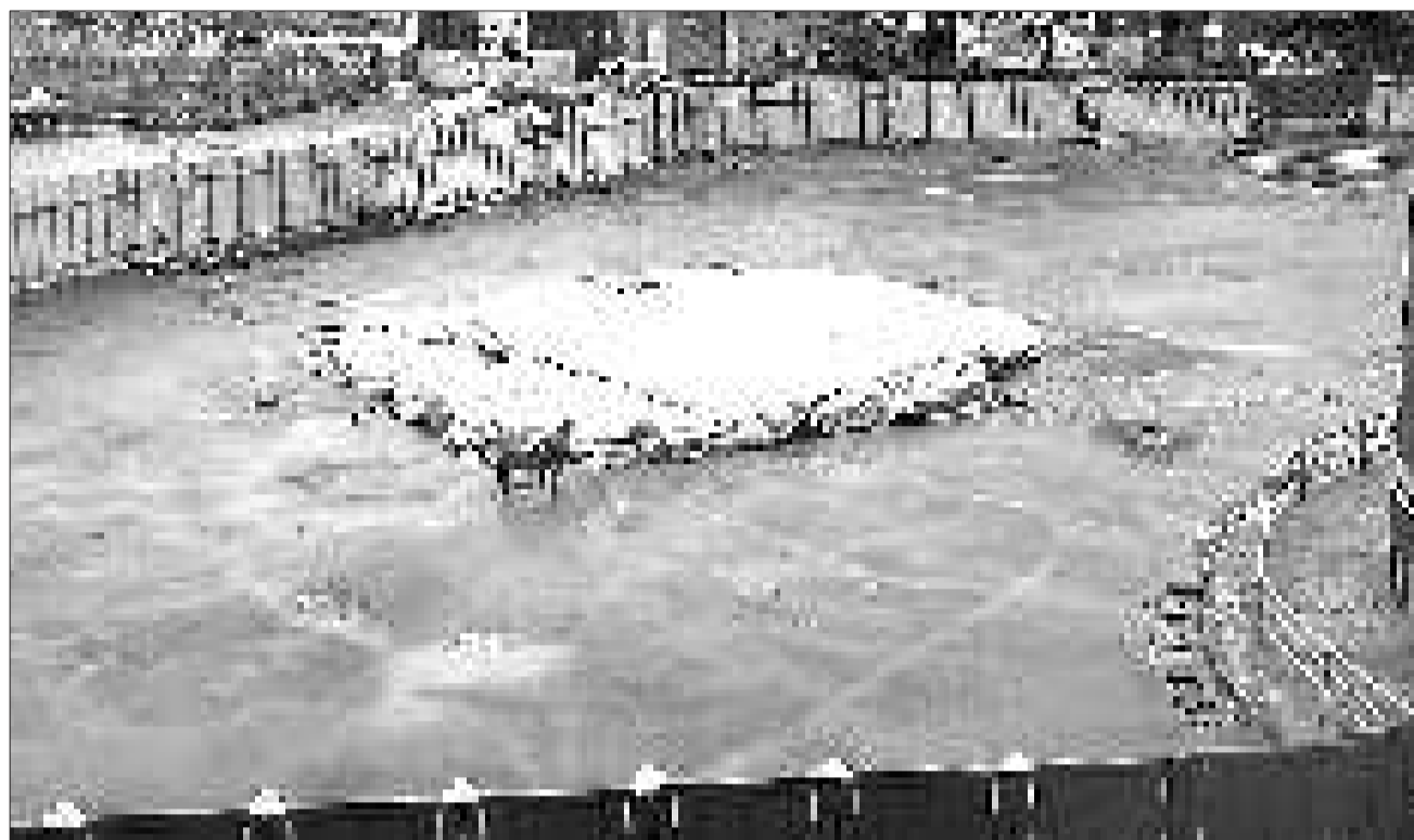
▲塌陷区已经回填。
