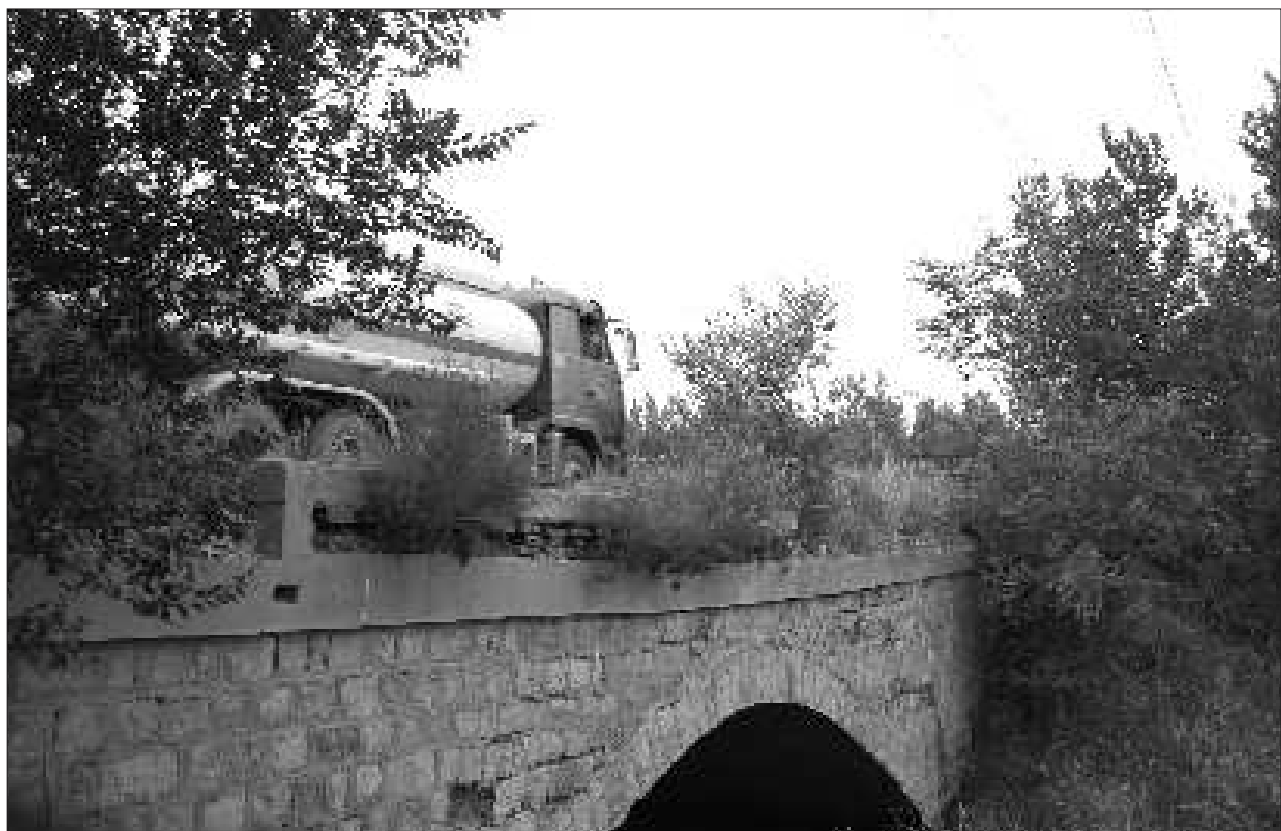
五类危桥中滨石路中段的刘尚文桥,开发区交通局已经在桥前标注了危桥标牌,但不时仍有大桥从此经过。见习记者 李运恒 摄
