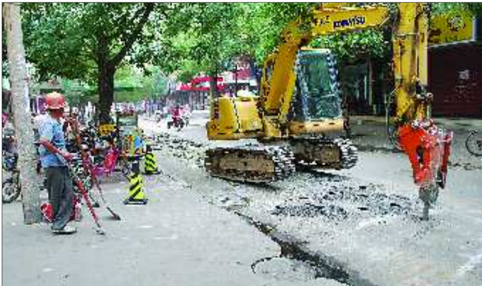
在刘庄路积水点改造现场,工人准备在路面破开后挖探沟。
