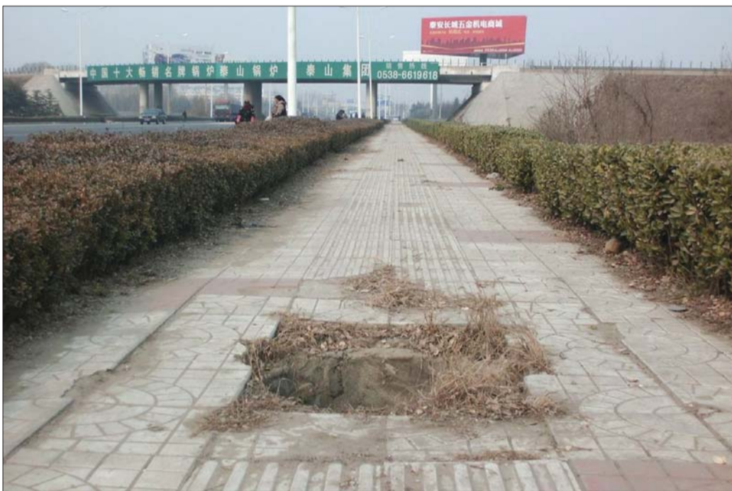
没有盖子的深井处在盲道上,非常危险。记者 刘来 摄
