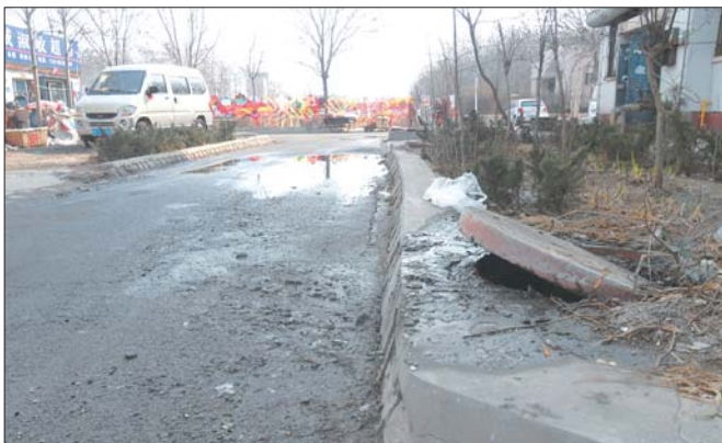
在府前小区的一处下水道,污水又冒了出来。
