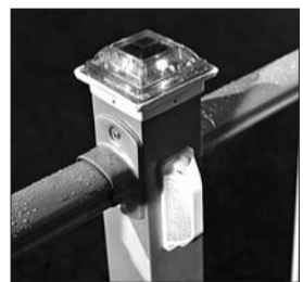
2日,施工人员在历山路南段路中央安装新护栏。新护栏矮、窄,还新增反光装置。图为太阳能反光立柱。 本报记者 徐延春 摄
