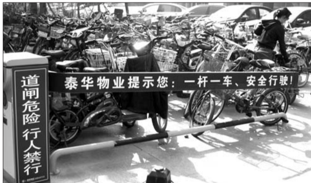
被撞弯的停车场刀闸杆。本报见习记者 王述 摄
