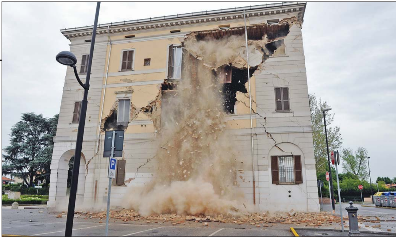
这是5月20日拍摄的,在意大利地震灾区圣阿戈斯蒂诺发生5.1级余震,受损的市政府建筑部分坍塌瞬间。新华社发
