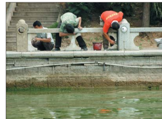
利民路运河桥下,三位工人正用河里捞出的护栏维修缺损处。
