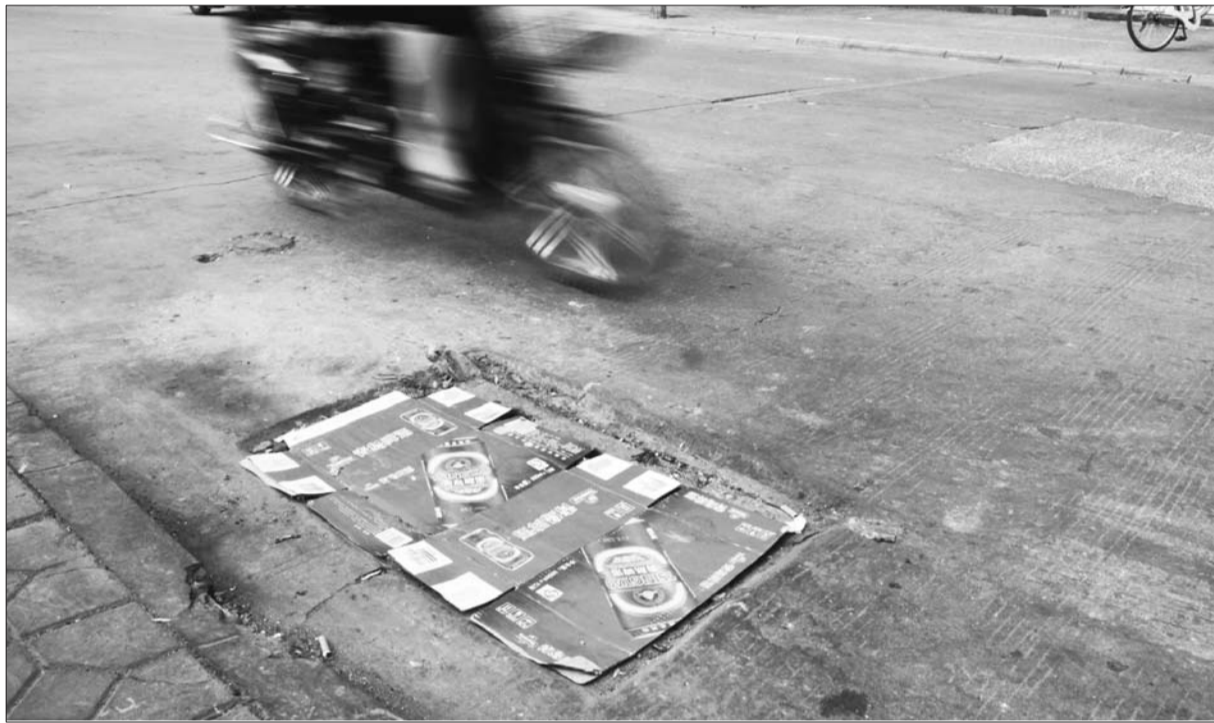
在吕家街,一个硬纸壳盖住了被餐厨垃圾堵塞的排水口。 本报记者 马志勇 摄
