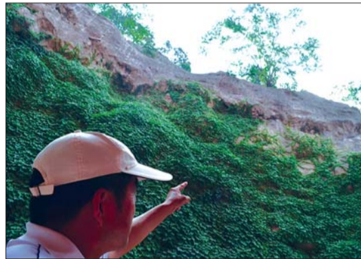
坡顶的那棵椿树已经撑开了固化用的水泥，汛期可能有滑坡危险。 本报记者 王光营 摄
