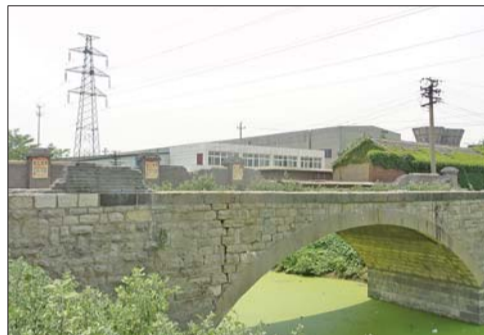
桥身出现多处裂缝，桥面破损，两侧护墙缺失大半。 拍摄地点：济南天桥区臧家屯小区迎济桥 拍摄人：读者李先生
