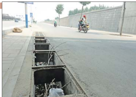
一连5个下水道井算子缺失，井里落满垃圾。 拍摄地点：济南奥体中路铁路桥下 拍摄人：读者刘先生
