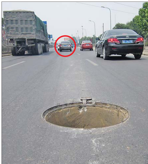
丢失井盖酿成事故的“黑洞”,爆胎的汽车被迫停了下来。见习记者 刘帅 摄
