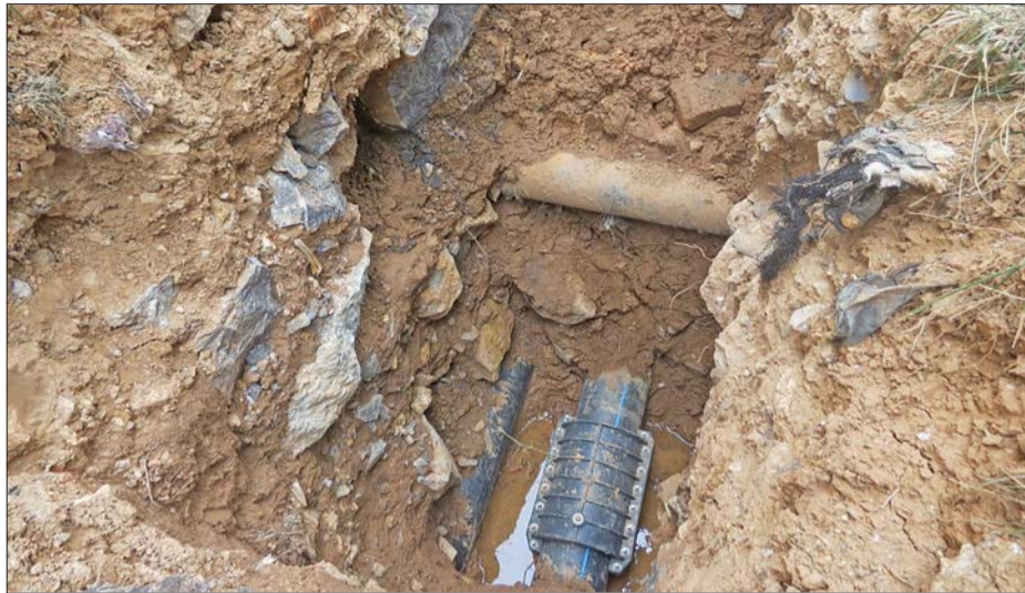
方填埋的石块清晰可见。昨日刚刚维修好的管道漏点,回填土中施工
