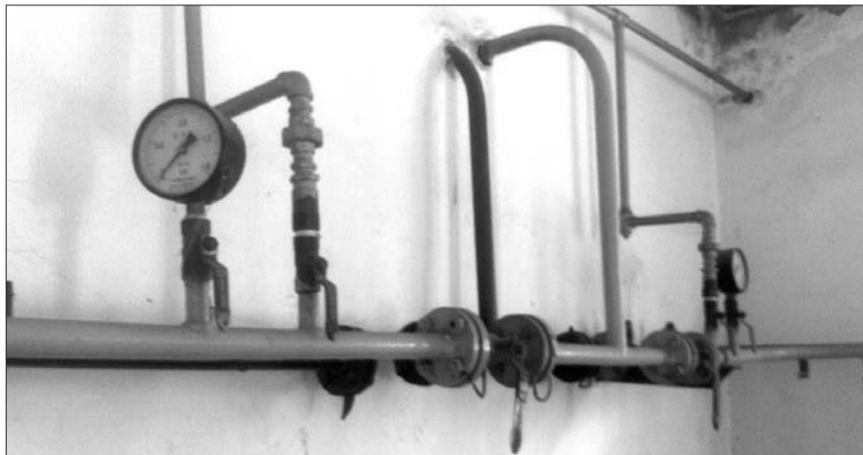
小区液化气站阀门压力表已停用。记者 孙淑玉 摄
