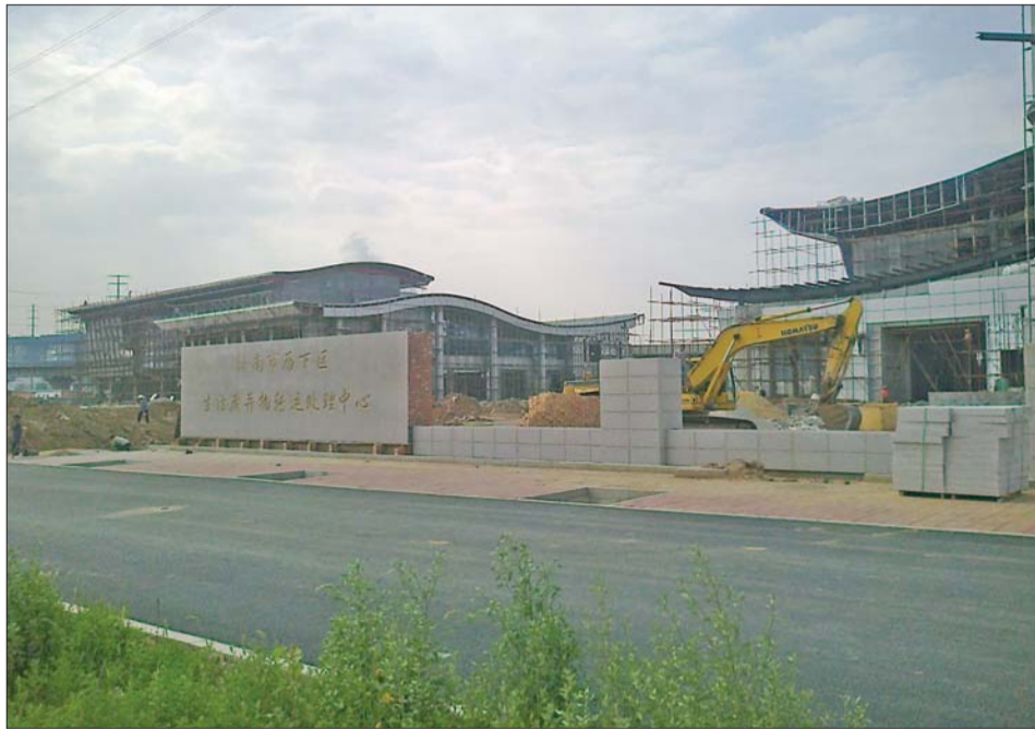
历下区生活废弃物转运处理中心建筑主体轮廓显现,工程预计下月基本完工。 殷亚楠 摄
