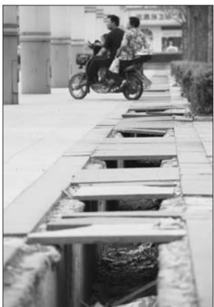
市民从破损严重的地沟板上经过。本报记者 王晓霜 摄
