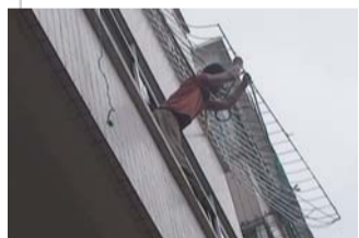
工人被困在3楼的窗台上。图片由通讯员提供
