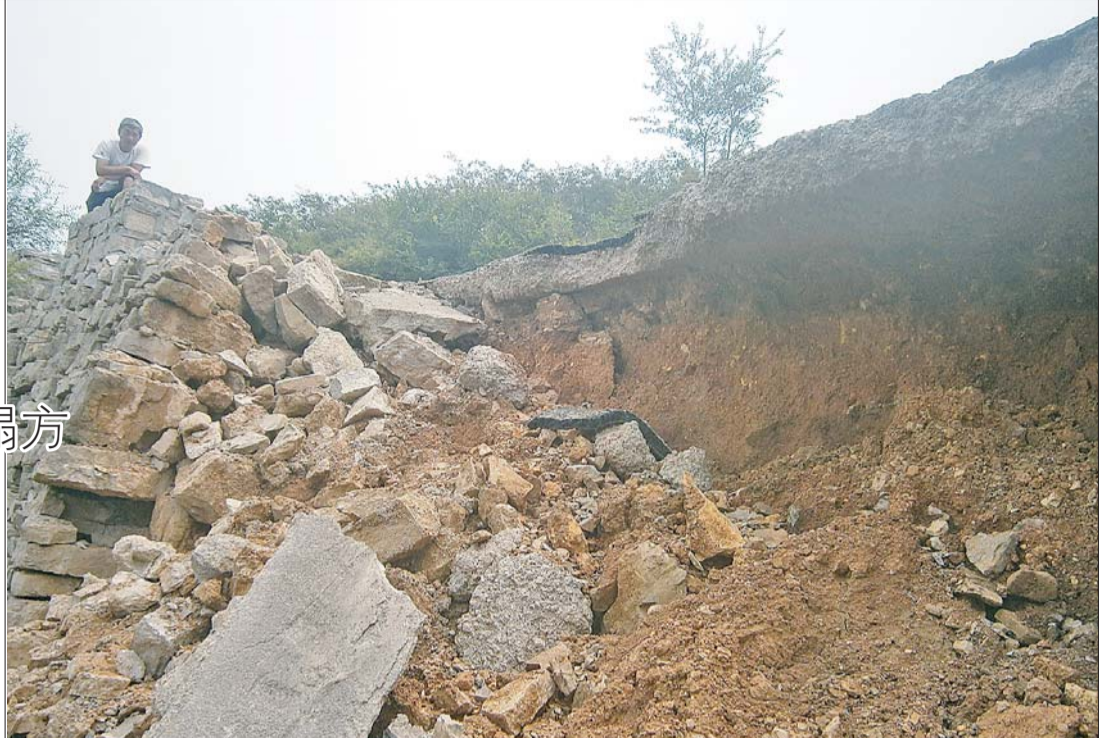
这段环山路下面的路基塌方,路面悬空,安全隐患很大。
