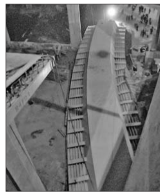
2009年南京在建高架桥倾覆事故现场。(资料片)
