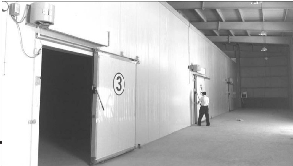
储备库已经竣工,设备调试完便可投入使用。本报记者 孙芳芳 摄
